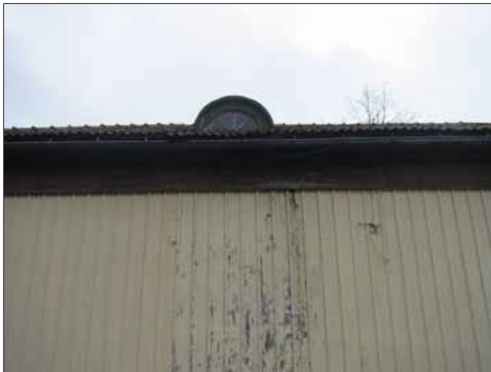
Vaurioituneesta räystäsrakenteesta valuva vesi tuhoaa nopeasti seinärakenteet.
