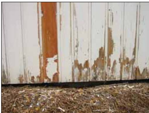
Liian matala kivijalka aiheuttaa lautaverhouksen alaosan kastumisen
